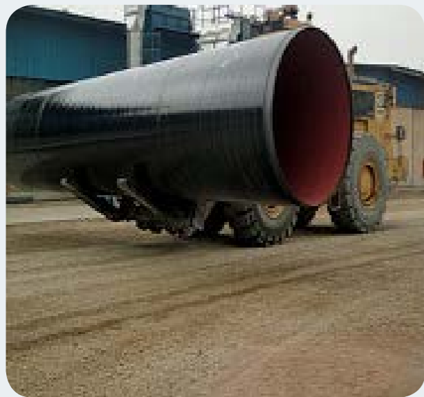
Salafchegan Pipe Protection Co.
